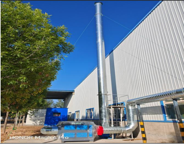
有组织废气排气筒
