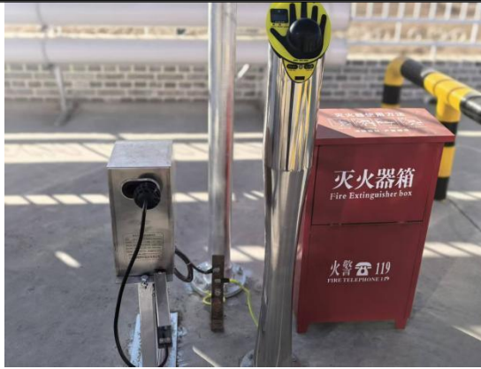
站内消除静电设施及灭火器
