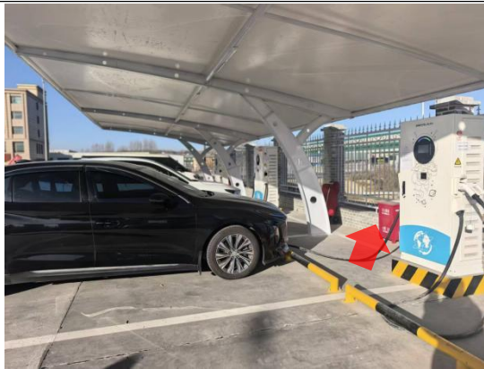
站内消防设施（充电区灭火器）
