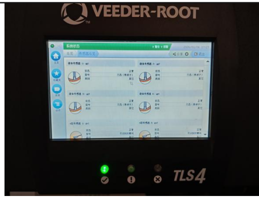
液位仪和油罐、管线泄露报警系统
