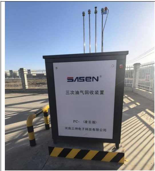
三次油气回收装置照片
