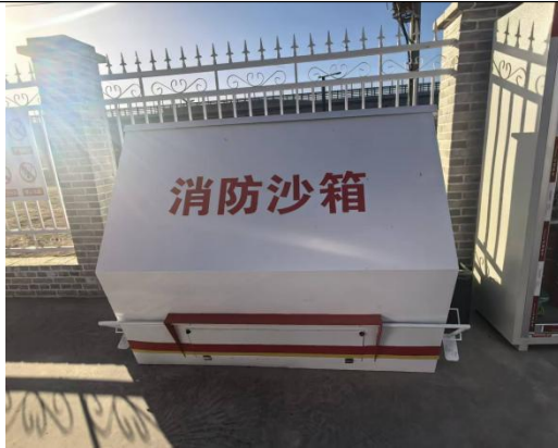
站内消防设施（消防沙）
